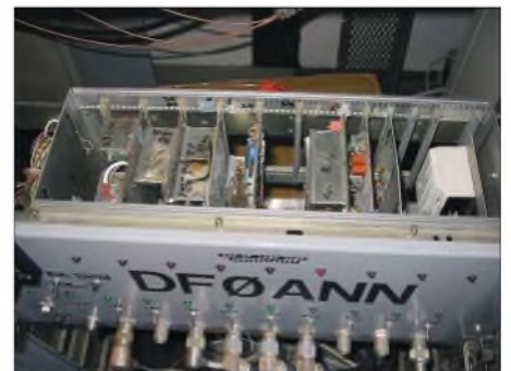
Das Grundgerät von DF0ANN; die Verstärker für die Endleistungen sind separat untergebracht.
