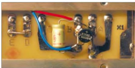
Blick in den Anschlusskasten Foto: DL2QZ
