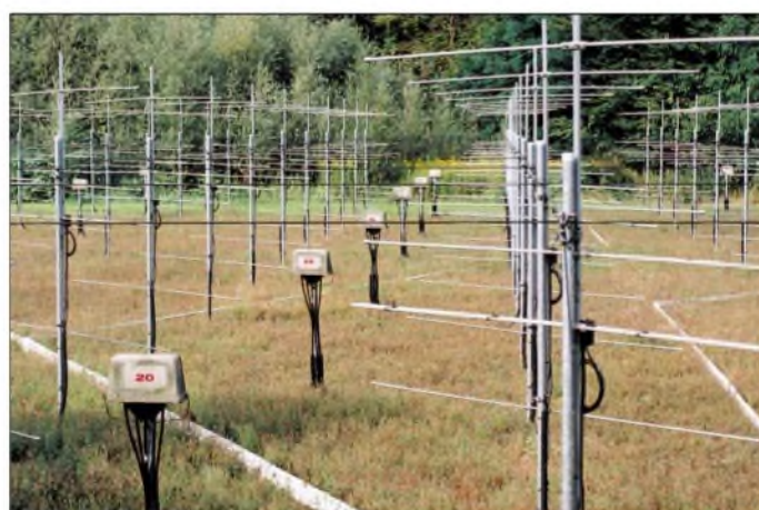
Bild 4: Blick auf das Antennenfeld mit 12 x 12 Vierelement-Yagis. Zwischen den Antennenreihen stehen die Splitter/Combiner für jeweils ein Subsystem von vier Yagis
