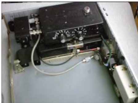
Rechts unten die Überwachungsschaltung, oben Mitte die beiden Akkus und darüber das Anpassgerät, links das SWR-Meter
