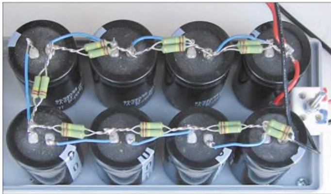
Bild 4: Bank mit acht Elektrolytkondensatoren à 330 µF/450 V und den jeweils paarweise parallelgeschalteten, für den Leckstromausgleich verantwortlichen Metalloxidwiderständen von 220 kΩ
