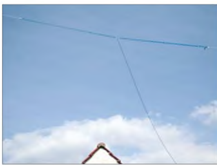
Wetterfest und unauffällig: Dierkings Dipol ist komplett montiert inklusive Antennenkabel und Stecker.
