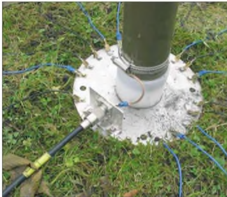
Bild 1: Der Mastfuß mit aufgesteckten 16 Radials für das Erdnetz
