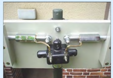
Bild 3: Fertig montiertes Mittelstück; es ist durch zwei Rohrschellen mit Gummieinlagen am Tragemast befestigt. Fotos: DL4OBP
