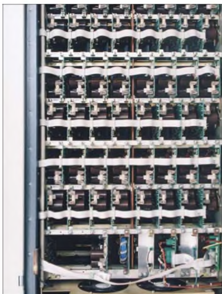
19"-Gestell mit 48 Verstärkermodulen
