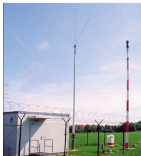
Sendecontainer und Antennenanlage der NDB ERT
