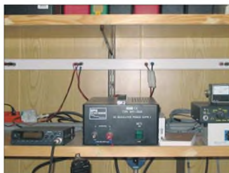
Der selbst gebaute Verteiler ist beliebig erweiterbar. Foto: DF1EZ
