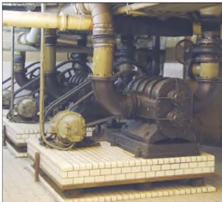
Bild 8: Gebläseapparate der Hausrohrpost im ehemaligen Haupttelegrafenamnt Foto: Stefan Lehmann
