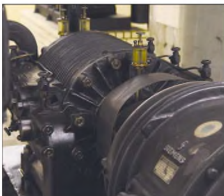
Bild 9: Gebläseapparate der Hausrohrpost im ehemaligen Haupttelegrafenamnt Foto: Stefan Lehmann
