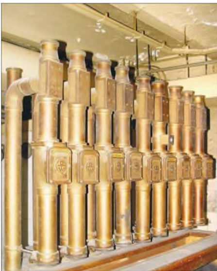
Bild 5: Hausrohrpostanlage (Empfangsstation) des Haupttelegrafenamtes
