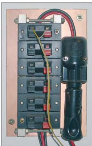
Bild 1: 13,8-V- Vertei- lung, an der Wand befestigt
