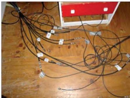
Erstaunlich, was da so alles zusammenkommt: diverse Koaxialkabel auf einen Blick.
