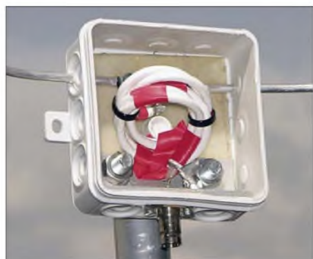
Bild 5: Blick in die Anschlussdose mit der Speisedrossel aus zweimal 75-Ω-Kabel parallel. Fotos (2) und Screenshots: DK7ZB
