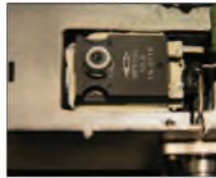
Bild 2: Widerstand 50 Ω / 100 W im eingebauten Zustand
