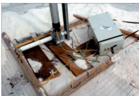
Wohl nicht ganz nach VDE; die Einspeisung der V160S-Vertikalantenne
