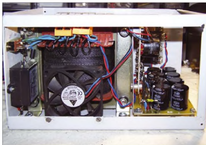
Bild 3: Links oben der 115-/230-V-Schalter, darunter ein Entstörglied; rechts unten die Hochspannungsplatine, daneben hochkant die Platine zur Versorgung der restlichen Spannungen
