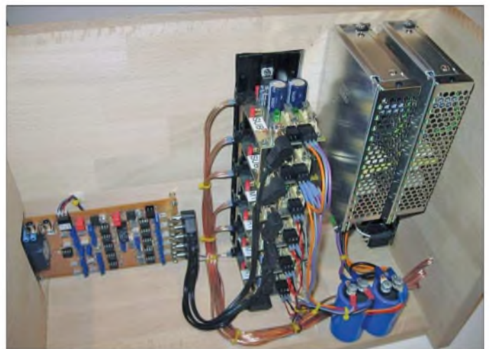
Bild 2: Innenansicht des Verstärkers mit Frequenzweiche, sechs Verstärkermodulen und Stromversorgung
