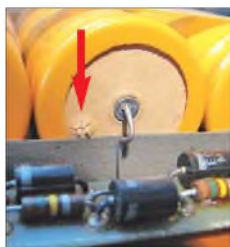
Bild 1: Defekter Hochspannungskondensator mit aufgeplatzter Kappe
