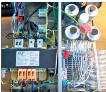
Bild 3: Blick auf die geöffnete PA; linke Kammer Netzteil und Steuerung, rechte HF-Teil
