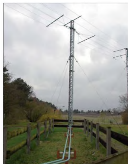
Speiseleitung und Einspeisung der Kurzwellenantenne
