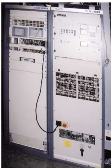
TRAM 10 von Transradio im Betriebsgebäude der Funkübertragungsstelle Berlin-Frohnau
