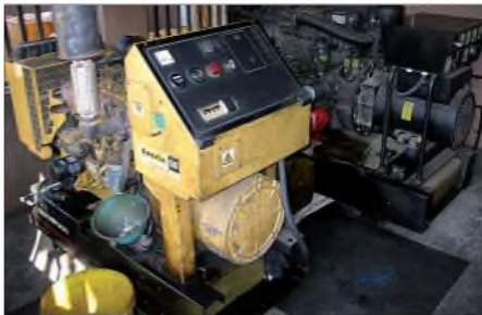
Hauseigene Stromversorgung – in Afrika von unschätzbarem Vorteil
