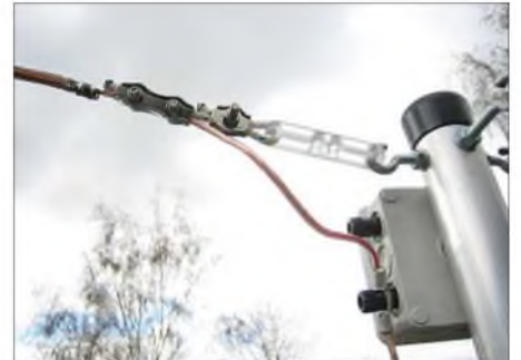
Bild 12: Der Strahleranschluss ist zugentlastet und schlaufenfrei. Der Schaltkasten dient nur als Halterung für die Polklemmen.
