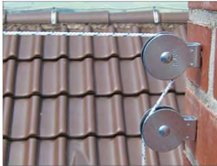
Bild 14: Umlenkrollen am Schornstein; die untere Rolle schafft Abstand für das Spannungsgewicht Fotos und Screenshots: DL1SNG
