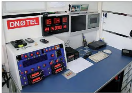
Arbeitsplatz in der mobilen Funkeinheit: Ausgestattet mit 4 x Dualbander 2 m/70 cm, DVB-T-Empfang, Monitor der Mastkamera, Wetterstation, zwei PC-Monitore (Logbuch, APRS oder auch SSTV) sowie Drucker für die Einsatzunterlagen
