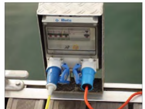
Bild 8: Ein spritzwassergeschützter Anschlusskasten für 230 V vom Land
