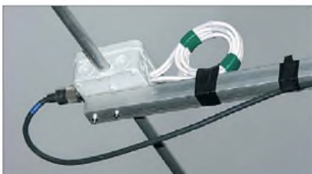
Bild 12: Aufgewickelte 6-m-Drossel außerhalb der Anschlussdose
