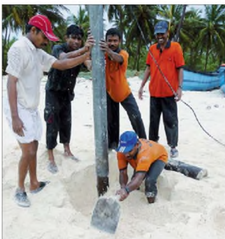
Der Mast für die Inverted-Vee-Antenne wird mit lokaler Unterstützung im Sandstrand errichtet: Gute Abstrahlung garantiert! Unweit stand die HF9V.
