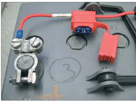
Bild 4: Akkumulatorabsicherung mit einer Flachstecksicherung aus dem Kfz-Bereich
