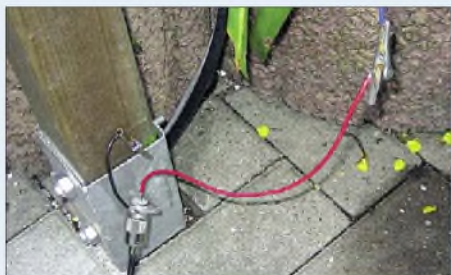
Bild 55: Provisorische Einspeisung der Vertikalantenne von DC1DV; an der Einschlaghülse laufen auch alle Radials zusammen.
