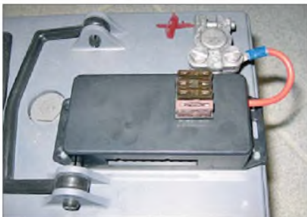
Bild 3: Absicherung eines Notstrom-Akkumulators Fotos: DL5IN
