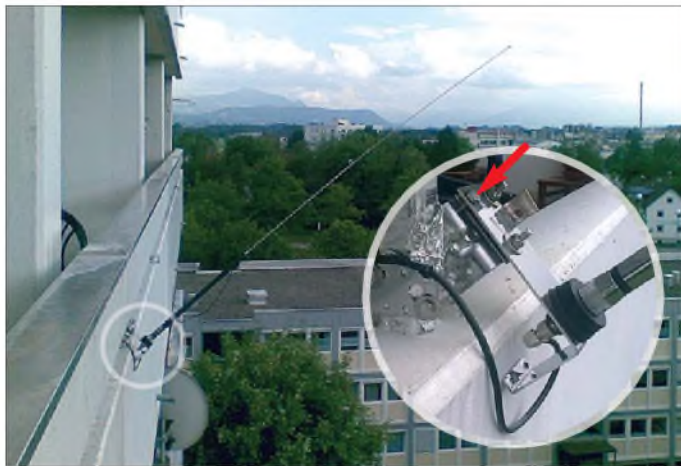
Bild 1: Ansicht der aufgestellten Antenne mit der vergrößert dargestellten Halterung und der Feststellschraube daran
