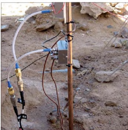
Einspeisung der Beverage-Antennen für 160 m
