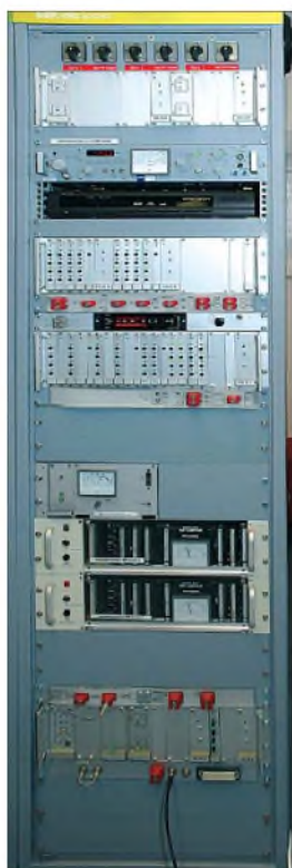
Bild 4: Modulationsgestell mit UKW-Empfänger, Satellitenempfänger, Umschalter, Dynamikkompressor für Glasfaser-signal; normalerweise wird die Modulation über Glasfaser direkt aus dem Studio in Hamburg empfangen, im Havariefall kann auf Satellit oder UKW-Ballempfang umgeschaltet werden.
