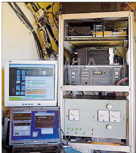
Der Blick in das Shack von SM1A offenbart es: Eine „dicke“ PA wie hier mit zwei GU74b sorgt auch für die nötige Feldstärke am anderen Ende des Funkkanals.
