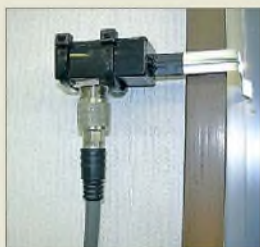
Fensterdurchführung mit PL-Anschlüssen
