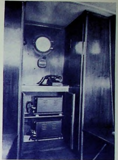
Bild 3. Radio-Telefonanlage in einem Schiff.
