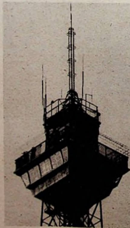
Die Spitze des Funkturms mit der V-tower-Antenne für den am Fuß des Turms aufgestellten 3-kW-UKW-Sender Berlin-Witzleben. Die Stabantennen an der Brüstung der obersten Plattform gehören zum Berliner-Pöitzel-Funknetz (Foto NWDR.)
