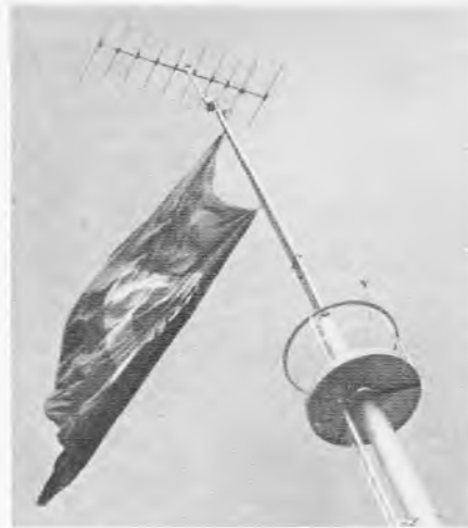
Bild 1. Der Antennenmast mit 10-Element-beam
