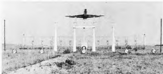
Bild 13. Der Landekurswingsender LK 2 der ILS-Anlage am Ende der Startbahn des Rhein/Main-Flughafens bei Frankfurt/Main. Foto: SEL.
