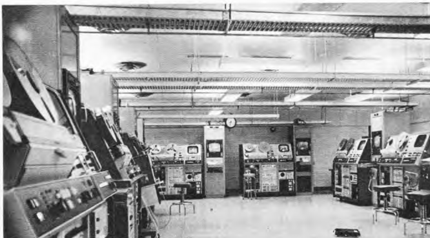
Bild 1. Blick in den Ampex-Raum des Delay Centre Calgary. Alle Vorgänge werden ferngesteuert, so daß nur eine Person ständig anwesend sein muß, etwa um die Magnetbänder auszuwechseln
