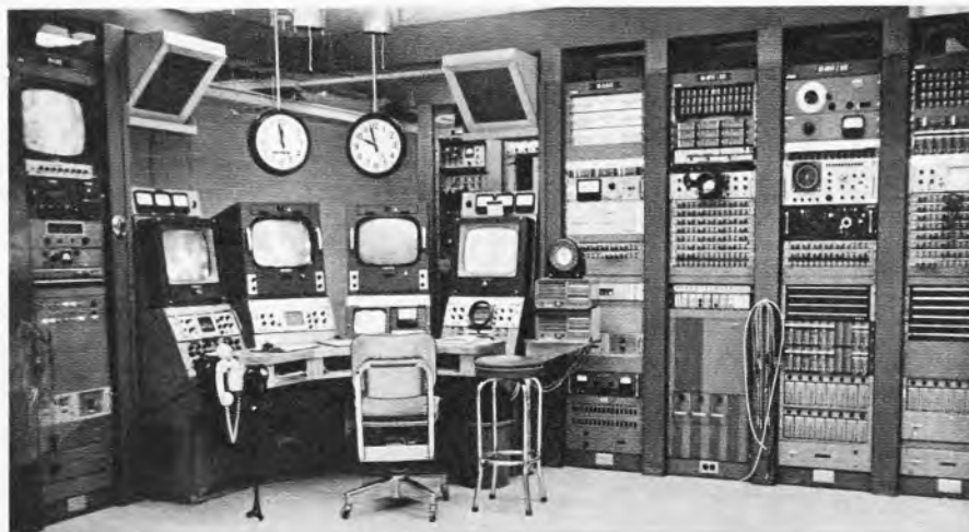
Bild 2. Teilansicht des Kontrollraumes mit Farbmonitoren, Überwachungs- und Testgeräten
