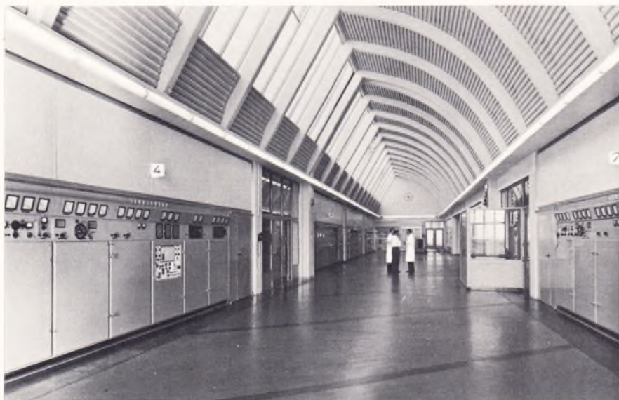
Bild 7. Senderhalle in Jülich mit 10 Sendern mit je 100 kW Leistung (Telefunken). Neun davon sind täglich 24 Stunden in Betrieb, der zehnte steht in Reserve
