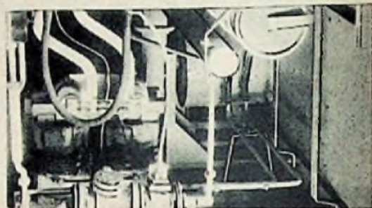
Von links nach rechts: Innenansicht des 30-kW-Hochfrequenz-Generators. Das Kühlaggregat, bestehend aus 5 Pumpen und 2 Gegenströmern
