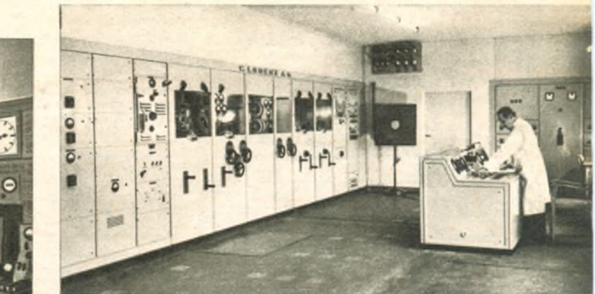
Der 20-kW-Lorenz-Sender, rechts im Hintergrund die Hauptschalttafel der Stromversorgung
