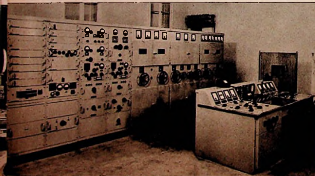
20-kW-Einseitenbandsender von Siemens & Halske
