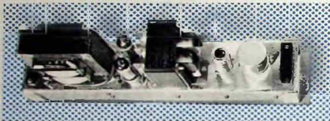
Bild 8. Auf dem Chassis des Endverstärkers erkennt man links den Netztransformator und in der Mitte den Ausgangsübertrager
