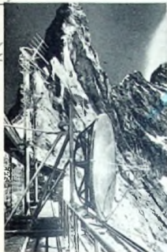
Die Parabolantenne in Richtung Süden der transalpinen Fernseh-Richtstrahlverbindung auf der Station Jungfrauoch, der mit 3700 m ü. M. höchsten Relaisstation Europas. Aufnahmen: PTT
