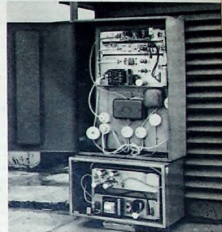
Bild 2. Die Vorverstärker der Gemeinschafts-Antennenanlage auf der Deutschen Industrie-Messe Hannover befinden sich am Fuße des Standrohres der Empfangsantennen
