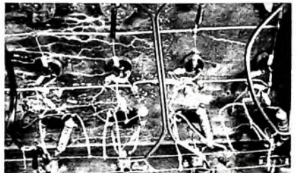
Bild 4. Blick in die Verdrahtung
