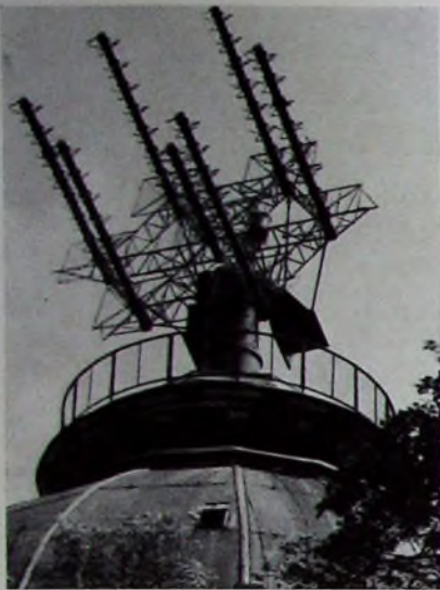
Bild 4. VHF-Antennenanlage für eine Keulennutations-Nachführanlage mit hydraulischer Antennensteuerung. Standort: Institut für Meteorologie und Geophysik der Freien Universität Berlin-Dahlem
