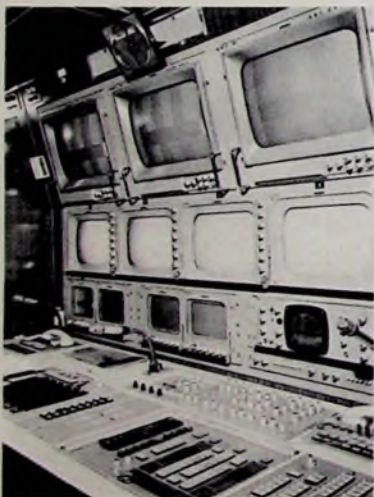
Blick auf Regiepult und Monitorwand der Bildregie (Aufnahme: Fernseh GmbH)
