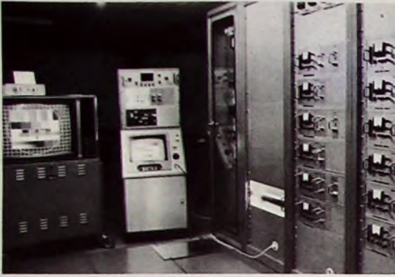
Bild 4 Blick in die Kopfstation
