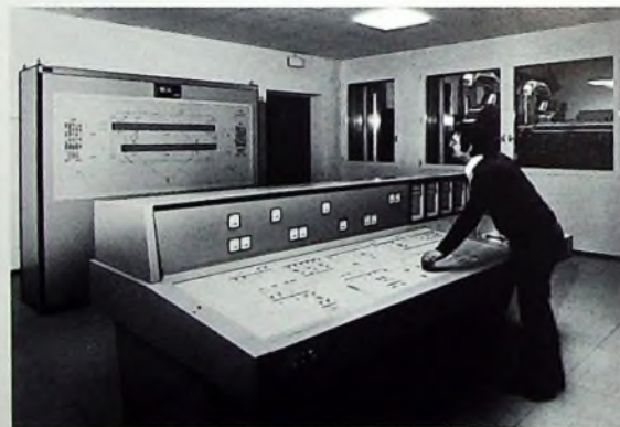
Blick in die Elektrozentrale des neuen Flughafens Berlin-Tegel mit Steuerpult und Symbolbild der gesamten Befehrsanlage
