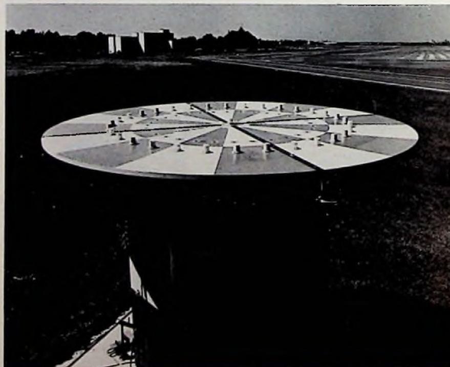
Bild 1: Bodenstation DLS-A; auf dem Dach 32 im Kreis angeordnete Antennen-Monopole
