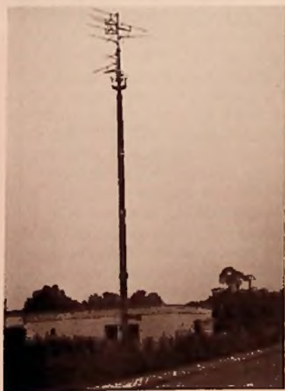
Bild 1. Empfangsantennen auf 30 m-Stahlrohrmast beim Fernsprechamtsgelände
