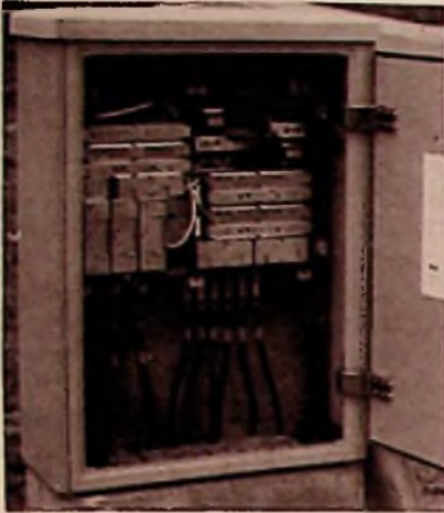
Bild 7. Verstärkerstelle (Nummer 3 in Bild 5) mit einer A-Leitung einer abzweigenden B-Leitung und sechs C-Leitungen. Verstärkergehäuse geöffnet
