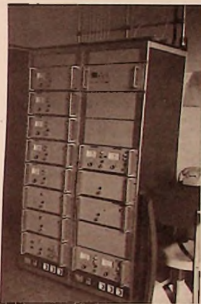
Bild 2. Aufbereitungsanlage im Post-Dienstgebäude links Empfangsgestell, rechts Sendegestell
