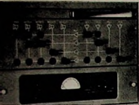
Abb. 11. Klinkenfeld des Vierkanal-Endverstärkers (S. & H., Abt. Klangfilm) für die Umschaltung der Lautsprecher auf einen der vier Verstärker
