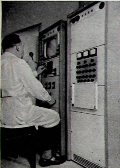
Bild 3. Im Technischen Kontrollraum befinden sich der Kamera-Verstärkerschrank (links) und der Kamera-Kontrollschrank (rechts)
