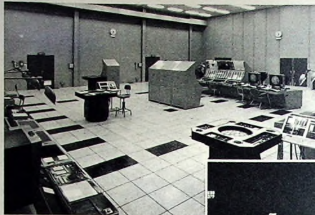
Bild 5. Blick in den Kontrollraum
