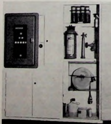
Bild 1 Kleine Signalzentrale (Cerberus), kombiniert mit Löschposten
