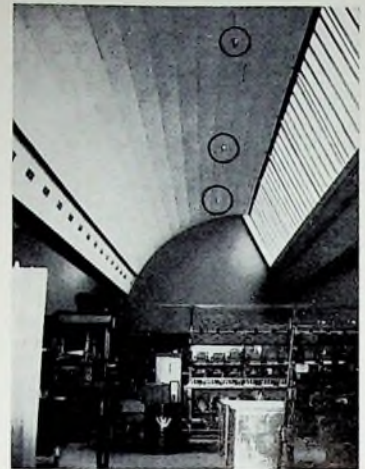
Bild 7. Schutz einer Lagerhalle durch an der Decke angebrachte Brandgasmelder
