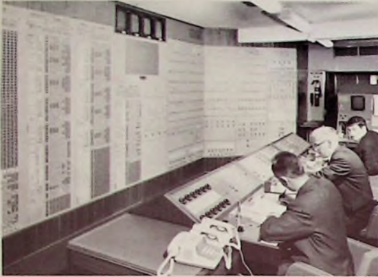
System-Kontrollraum, Brennpunkt aller technischen Einrichtungen und Überwachungen des „Mediator“-Komplexes
