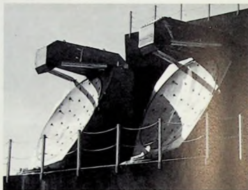
Bild 3 Antennen mit 1,5 bis 2,4 m Durchmesser für Richtfunk-Abzweignen
